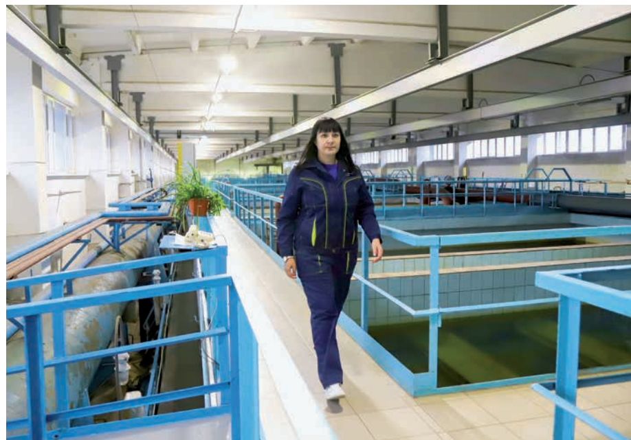
Работу скорых фильтров водоочистных сооружений контролирует оператор Ольга Чугунова
